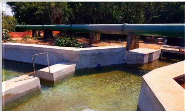
Captação do Ribeirão Bananal
