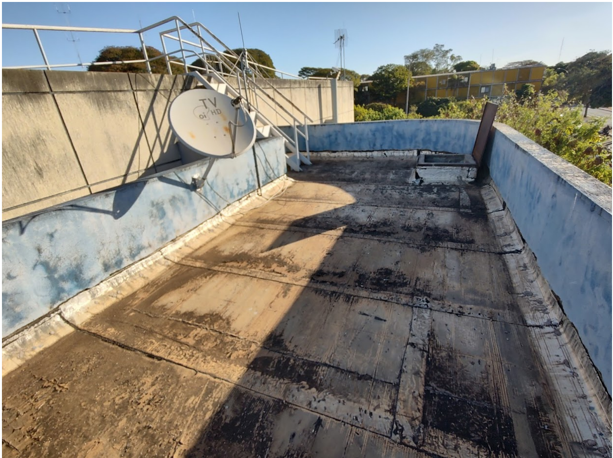
Figura 4: Cobertura - manta a remover
