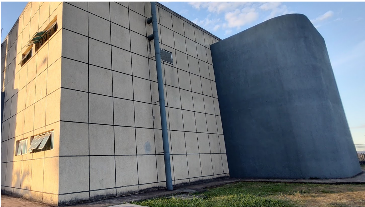
Figura 5: Tubulação de descida de águas pluviais na fachada
